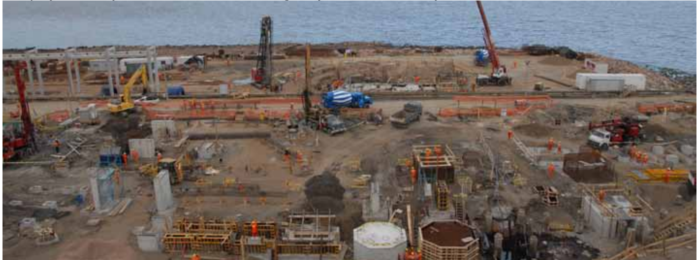
Trabajos para nueva planta de hidrodesulfuración de gasoil y trenes Claus de recuperación de azufre
