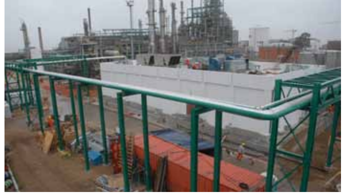
Nueva sala de control unificada para toda la refinería
